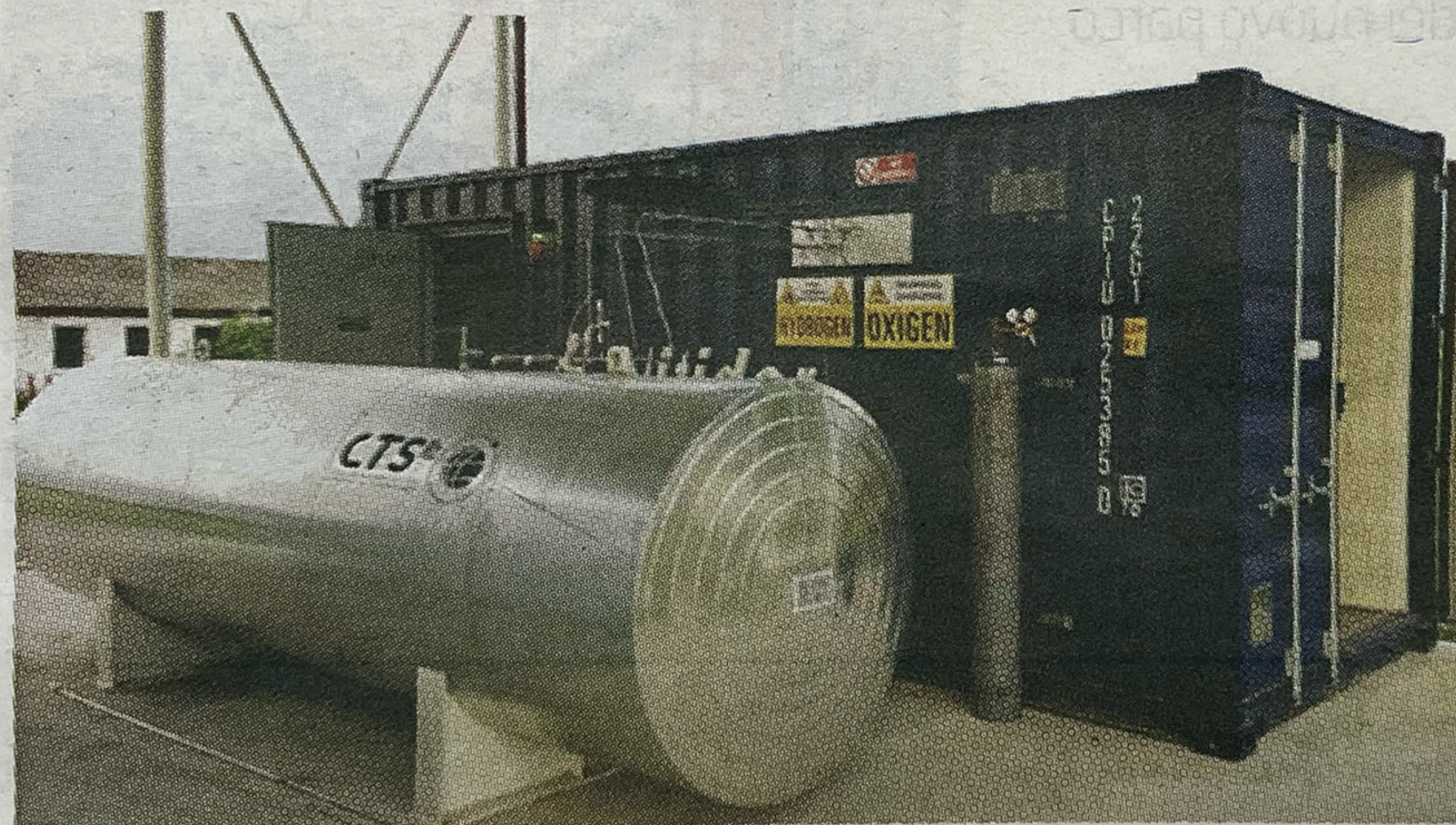
L'impianto per produrre idrogeno dall'acqua piovana realizzato dalla startup di Brugnera
